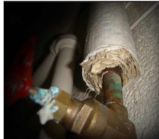
早期的管線絕緣常有石綿成分
